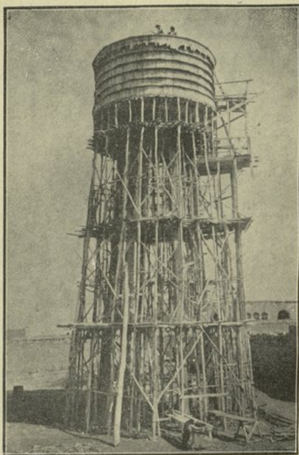
مشروع اسالة مياه منبج صورة خزان التوزيع وهو قيد الانجاز يستوعب ٨٠ متراً مكعباً من الماء ويرتفع ١٨ متراً عن سطح الارض
