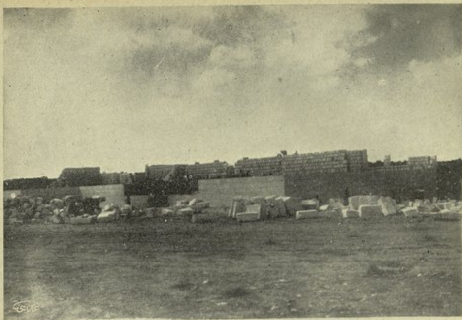
بناء المدرسة الأكاديمية في معرة النعمان وتبلغ مساحتها ٨٠٠ متر مربع - منظر الواجهة الرئيسية أثناء البناء
