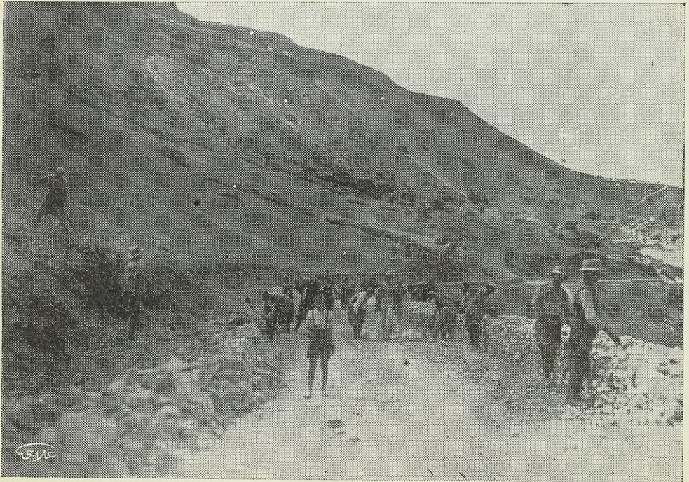
ورشة اعمال تعبيد طريق الهامه - فيجه - التكيه وهو الطريق المعروف باسم طريق المصايف
