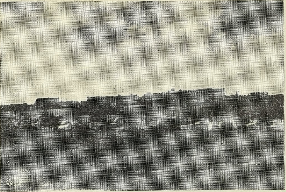
بناء المدرسة الاكاديمية في معرة النعمان وتبلغ مساحتها ٨٠٠ متر مربع - منظر الواجهة الرئيسية اثناء البناء
