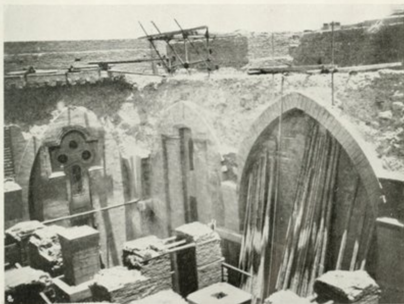
Fig. 6. — Vue des arcs accolés aux murailles pendant leur démolition. (Le cliché laisse voir en A la naissance des arcs prévus seulement sur le pilier central).
