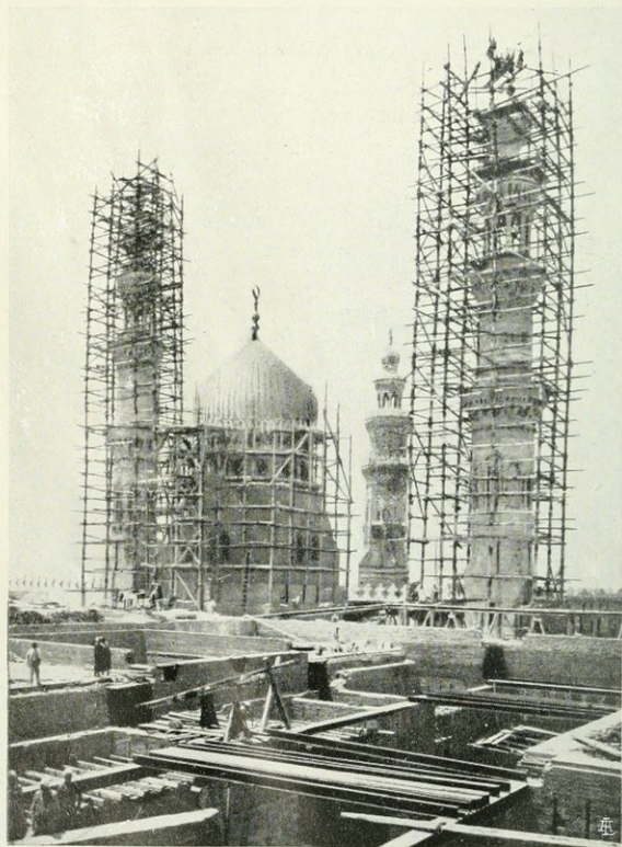
Fig. 14. — Vue du chantier lors de la construction des minarets et de la coupole sud.
