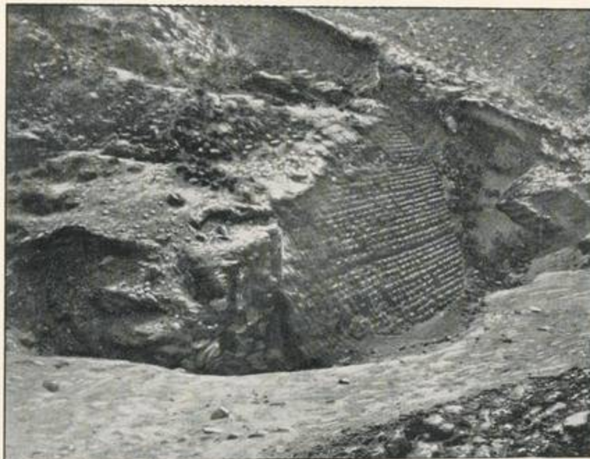
Abb. 57. Ende der nördlichen Futtermauer, von Nordwest gesehen. Die Kalksteinfuttermauer (links) vor der Ziegelfuttermauer (rechts) sichtbar.
