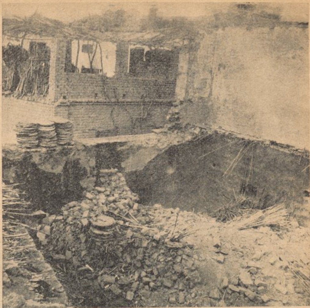
الصورة رقم ٥ - انهار هذا المسكن في قرية قلتي الكبرى بسبب تأكل الجدران المبنية من اللبن .
